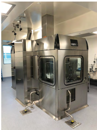
DP-Anlage von außen.
